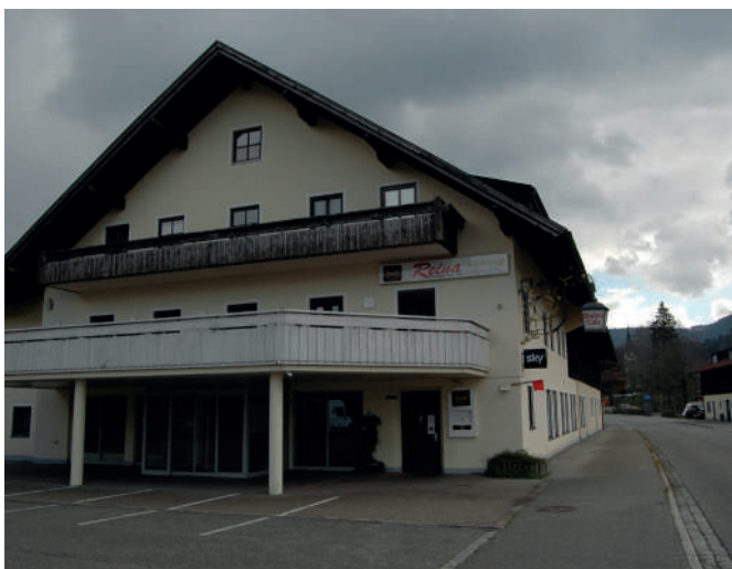
Vorgelagerter Balkon, störende Fassadenelemente und Werbeschilder
